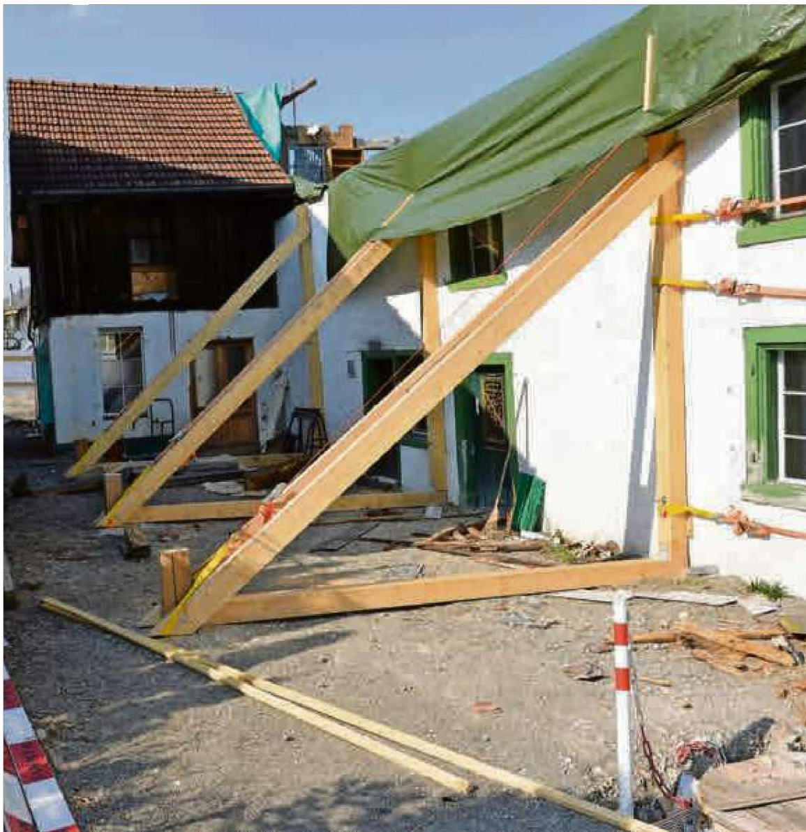
Das wenige, was vom Haus noch übrig ist, muss gestützt werden. Bild: Urs Weisskopf
