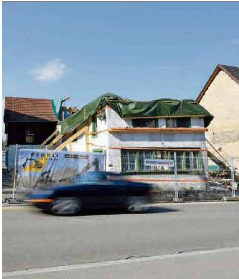
Viel ist nicht mehr übrig: das geschützte Haus im Dorfzentrum. Bild: weu
